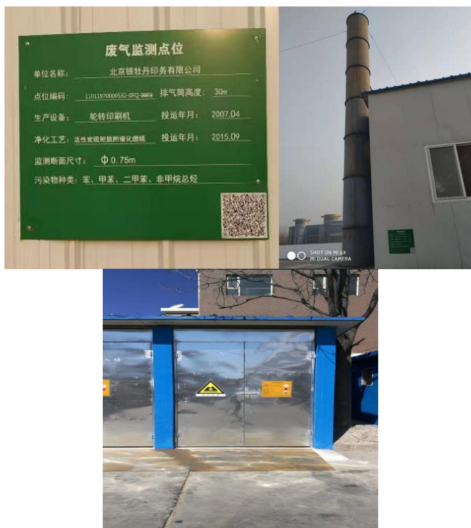
废气排气筒及危废间
